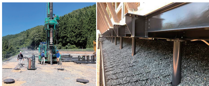
▲杭を正確に打設していきます ▲杭頭接合部。ECS-TP 工法で杭と鉄骨土台を一体化することで基礎コンクリートは不要。工期も短縮できました
